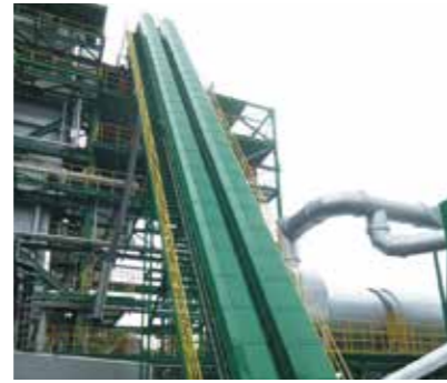
2 バイオマス発電燃料供給コンベヤ
