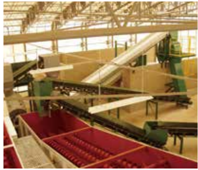
① 鶏糞搬送設備
