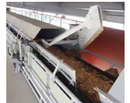
12 中間払出装置
