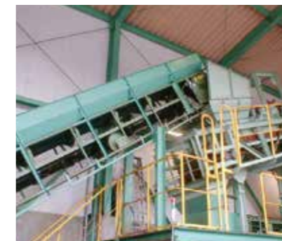
⑪ ゴミ搬送コンベヤ
