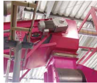
4 カレット搬送コンベヤ
