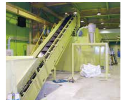
⑨ ペットボトル搬送コンベヤ
