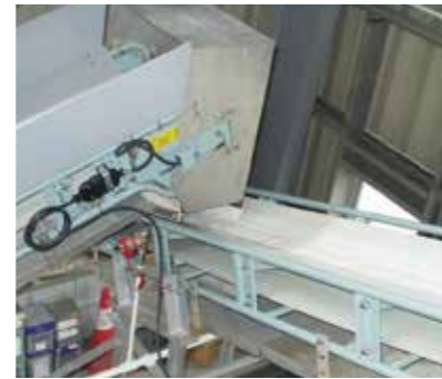
⑥ 塩搬送コンベヤ
