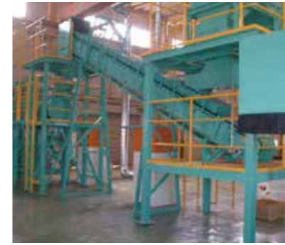
① ブラウン管破砕物搬送コンベヤ
