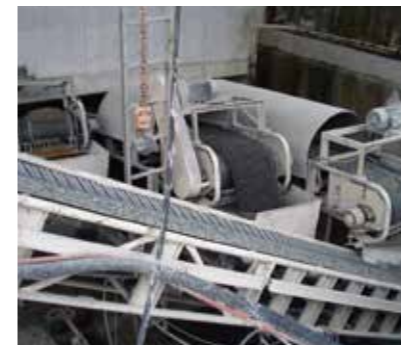
⑦ 砂・砂利搬送コンベヤ
