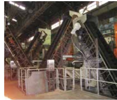
6 原料搬送設備 (パイプフレームフレックスコンベヤ)
