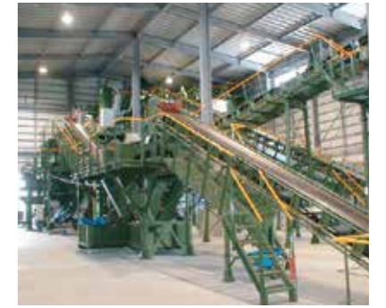
③ 土壌改良設備
