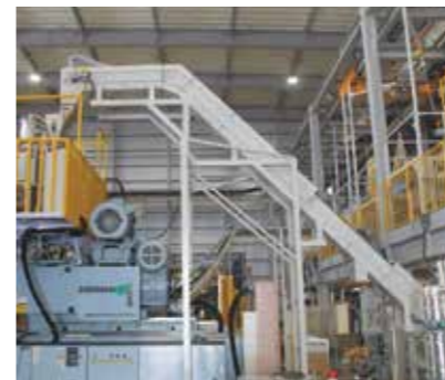
10 プラスチック材料搬送コンベヤ
