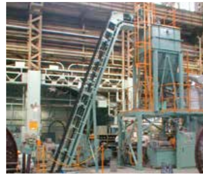
5 鉛片搬送コンベヤ (パイプフレームフレックスコンベヤ)
