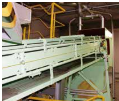
⑩ カレット搬送コンベヤ
