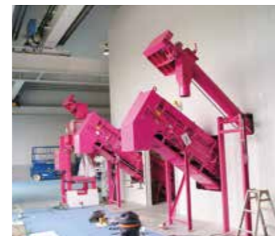
⑩ カレット搬送コンベヤ
