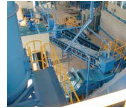
② 不燃物・可燃物搬送コンベヤ
