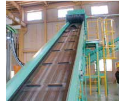
2 ブラウン管破砕物設備
