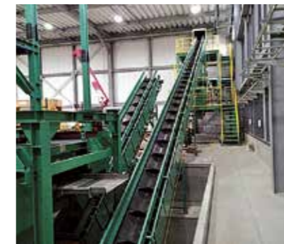
⑧ 廃家電搬送設備
