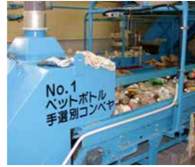
1 ペットボトル搬送コンベヤ
