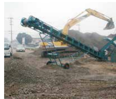
⑫ 土砂搬送コンベヤ (油圧モータ)
