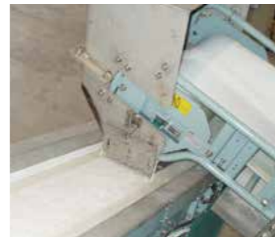
⑨ 塩搬送コンベヤ
