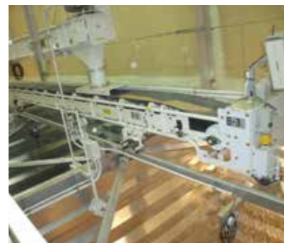
⑪ 穀物搬送コンベヤ
