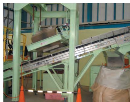
舟底型 廃プラスチック 鉄分除去ライン
