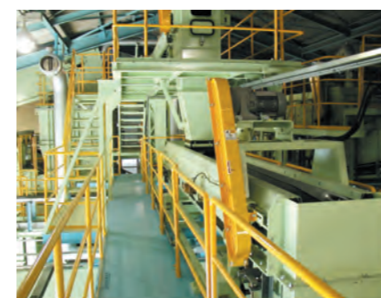
舟底型 RPF 製造設備 紙搬送コンベヤ
