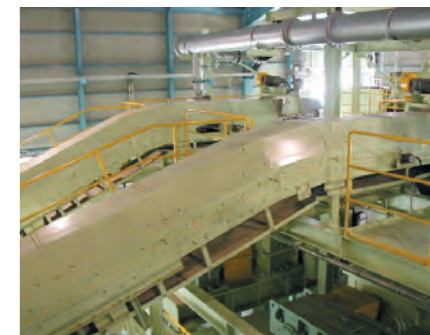
舟底型 RPF 製造設備 廃プラスチック搬送コンベヤ
