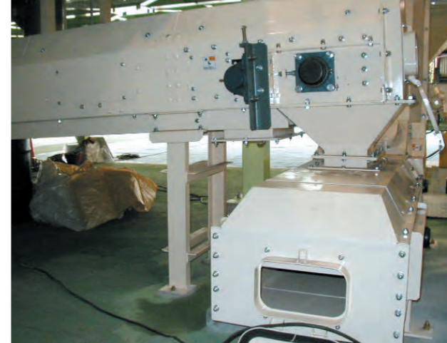
廃蛍光管カレット搬送ライン 舟底型
