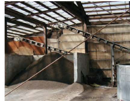
舟底型 堆肥プラント
