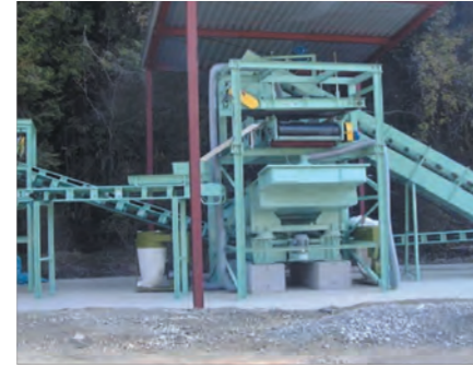
舟底型 建設廃棄物処理プラント
