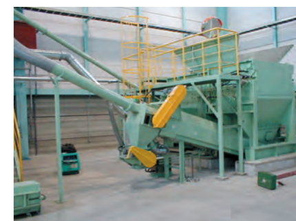
舟底型 破碎廃プラスチック 搬送設備
