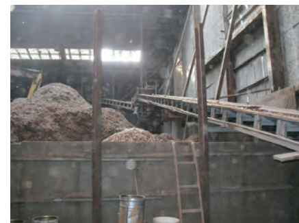
舟底型 木材チップ搬送コンベヤ
