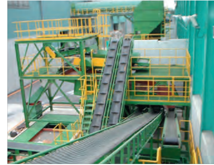
クライマ型 舟底型 廃木材処理プラント (チップ搬送コンベヤ)
