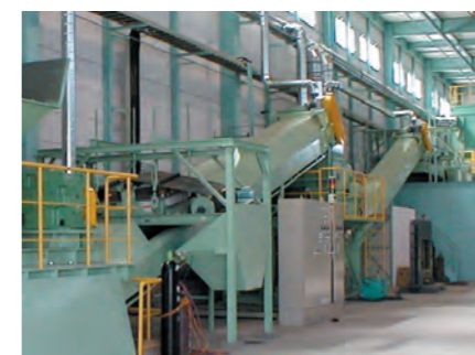
舟底型 廃木材搬送設備
