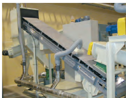
舟底型 石膏搬送コンベヤ
